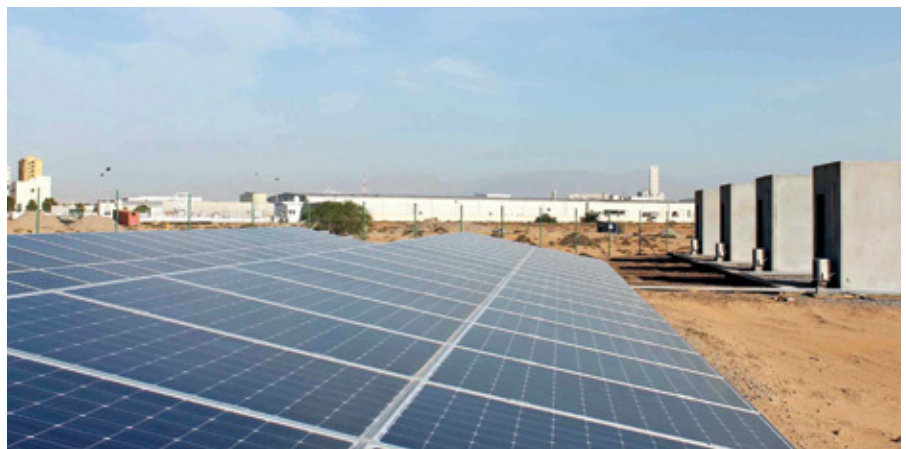
2 pv mini power plant - csem-uae. Courtesy of CSEM
